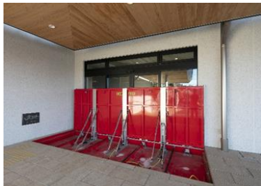
正面玄関防水板
